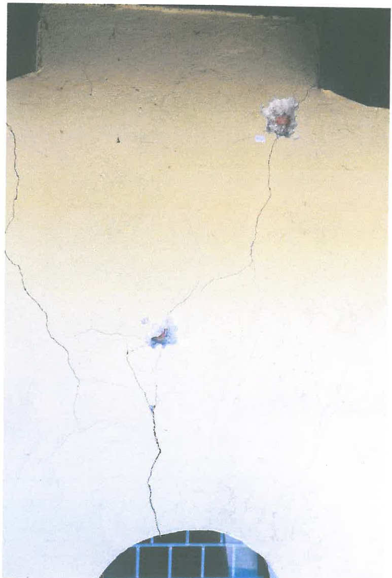
Widok spękań zakwalifikowanych do przeszycia prętami spiralnymi.
