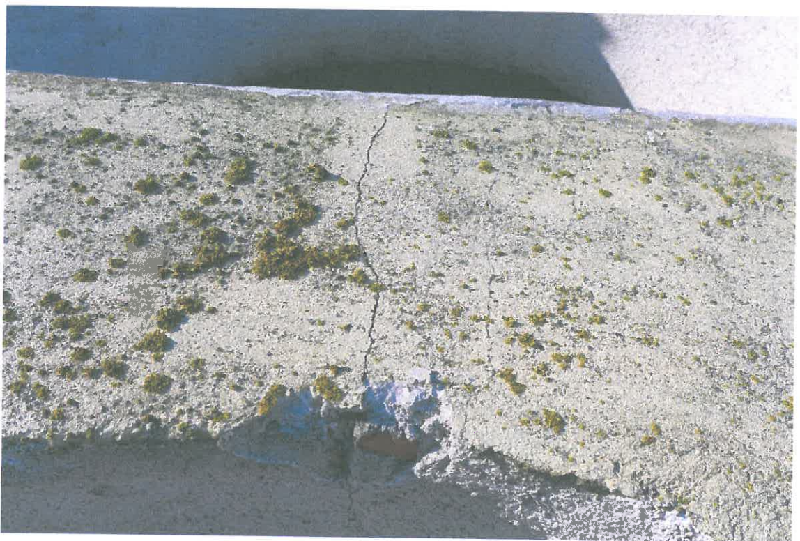
Widok spękań i glonów na tynku
