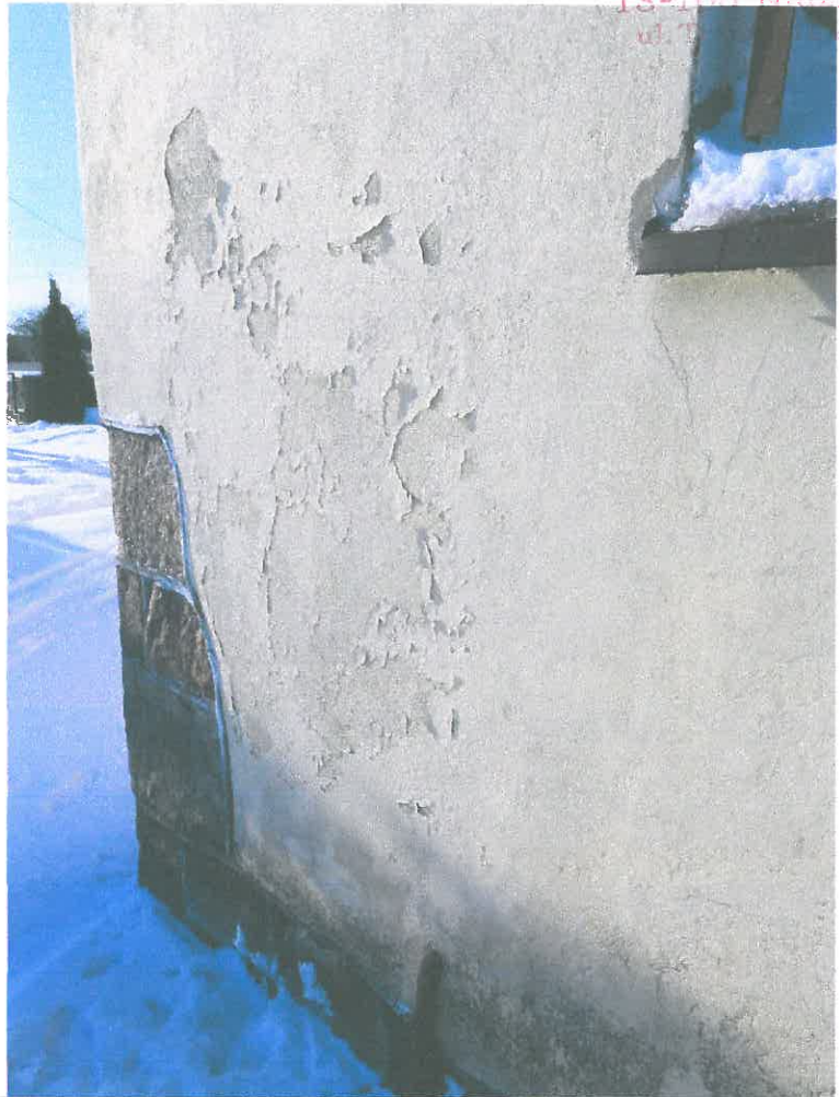
Fragment tynku z widocznymi zluszczeniami farby
