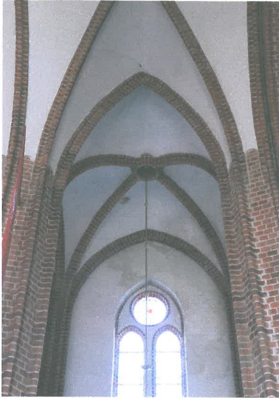
Fot. 5. Kościół p.w. Jana Chrzciciela w Janowcu Kościelnym. Widoczne pęknięcie wysklepka oraz plamy świadczące o zawilgoceniu ściany i sklepienia.
