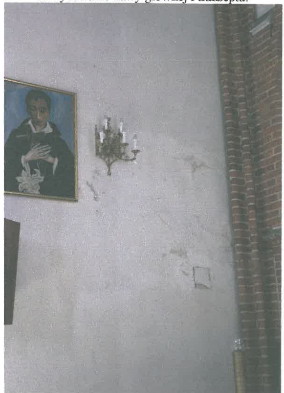
Fot. 8. Kościół p.w. Jana Chrzciciela w Janowcu Kościelnym. Widoczne uszkodzenia tynków ściany obwodowej wsch. na skutek zalania wodą.
