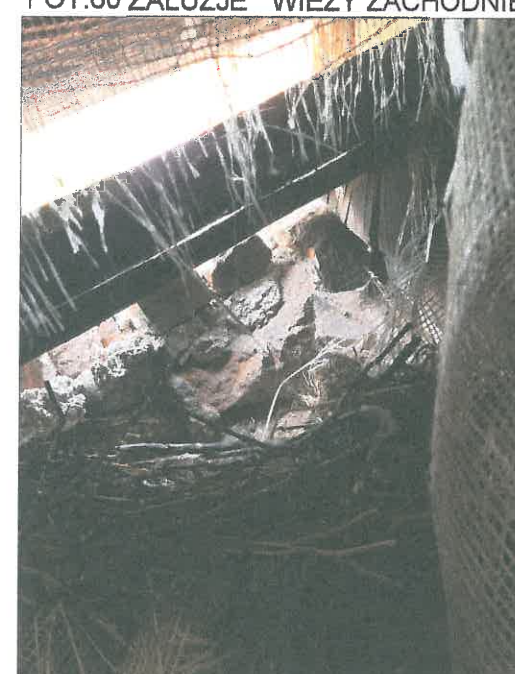
FOT.64 ŻALUZJE WIEŻY ZACHODNIEJ.
