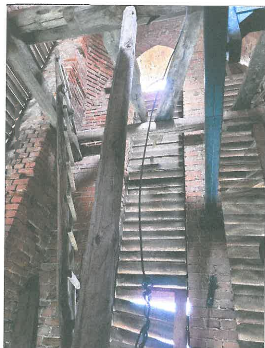
FOT.54 ŻALUZJE WIEŻY ZACHODNIEJ.
