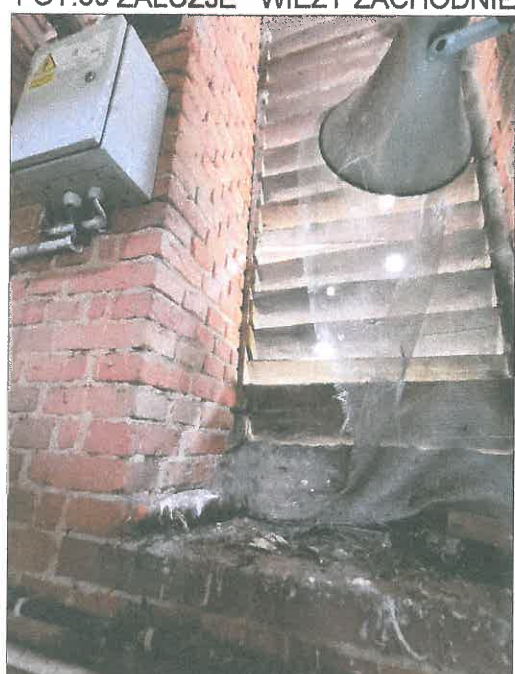
FOT.63 ŻALUZJE WIEŻY ZACHODNIEJ.
