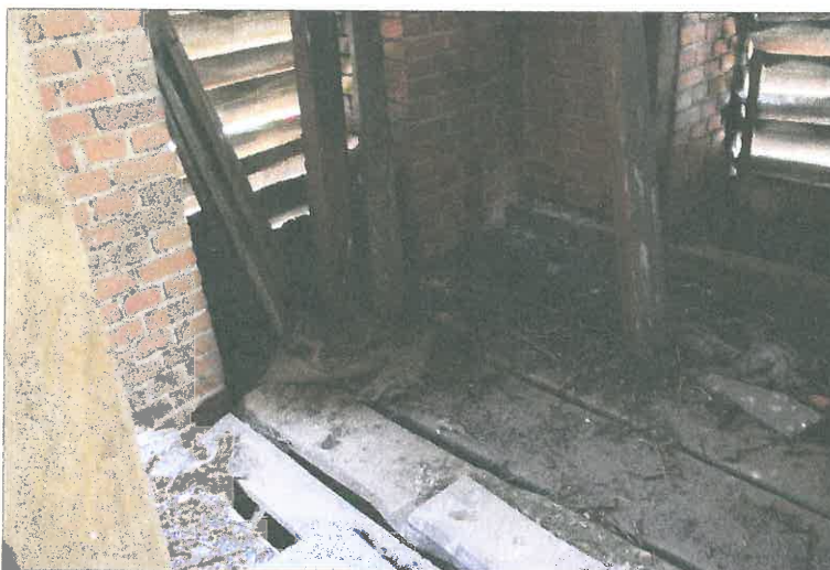
FOT.58 ŻALUZJE WIEŻY ZACHODNIEJ.
