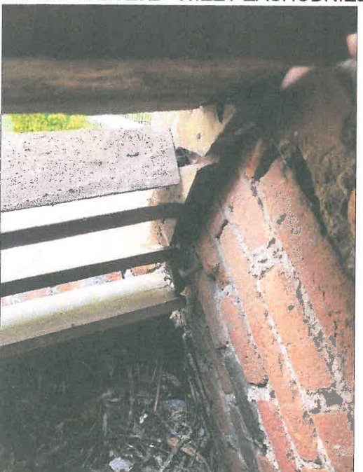
FOT.61 ŻALUZJE WIEŻY ZACHODNIEJ.
