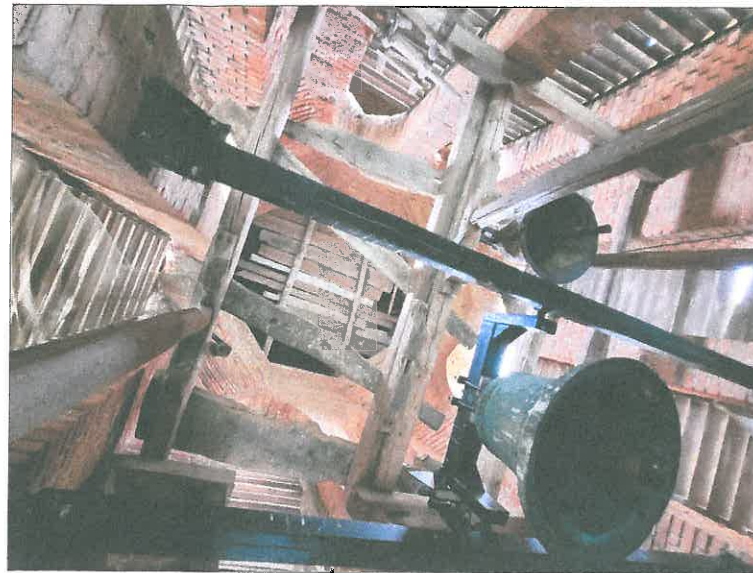
FOT.55 ŻALUZJE WIEŻY ZACHODNIEJ.
