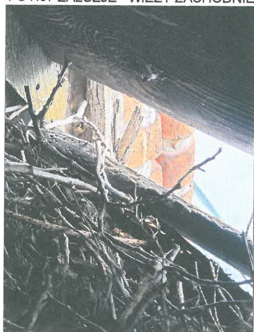
FOT.62 ŻALUZJE WIEŻY ZACHODNIEJ.
