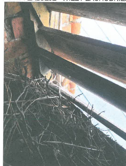
FOT.57 ŻALUZJE WIEŻY ZACHODNIEJ.
