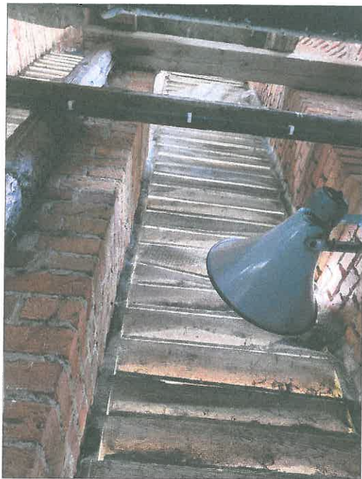
FOT.53 ŻALUZJE WIEŻY ZACHODNIEJ.
